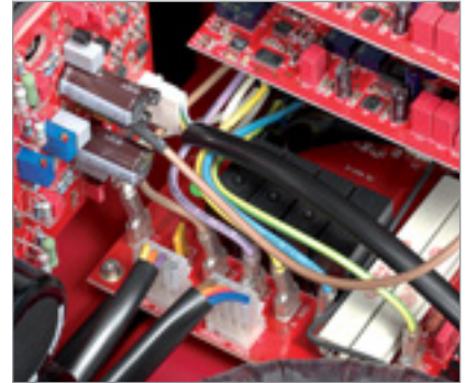
Widerstände und Relais halten den Einschaltimpuls des Riesentrafos in Schach
